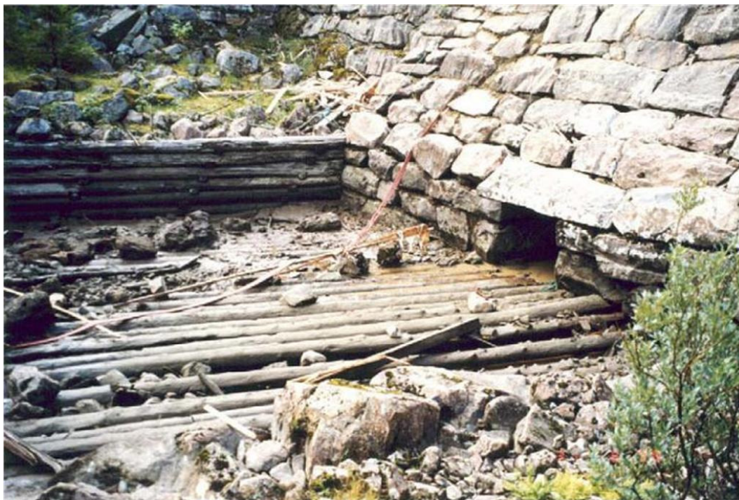
Bilde 12 Gammelt styrtgulv som ble delvis ble ført bort med elva under flommen. Bildet er tatt 31. aug. 1998, og en kan allerede på dette tidspunktet se at styrtgulvet er i dårlig forfatning. (foto: ukjent)
