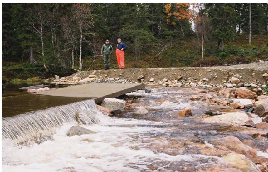
Bilde 9 Betongplata på overløpet ble undervasket og masser ble erodert bort fra terskelen ved Lilleferja. (Foto: Verran Kommuneskoger KF).
