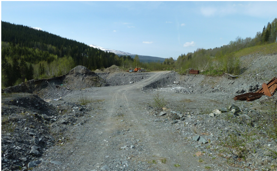
Hjelpeanlegg til vannkraftanlegg skal ikke benyttes som deponiområde. Foto: Jon Atle Eie.
