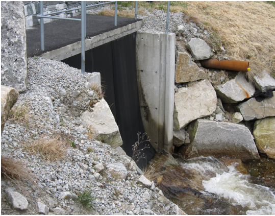
En gummimatte i utløpet fra kraftverket vil være et støyreducerende tiltak. Oftedal kraftverk. Foto: Jan Henning L'Abée-Lund
