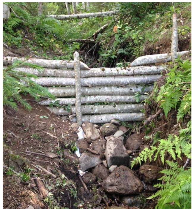
Bilde 4: Stokkdam med fiberduk over nederste stökk som er steinsatt for å hindre erosjon.
