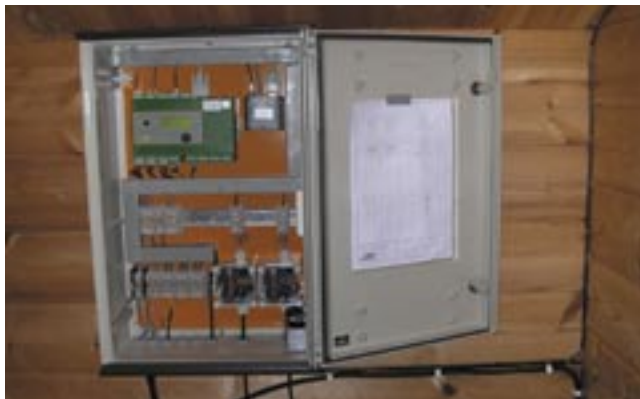
Den nye instrumenteringen montert på stasjon Leirbotnvatn
