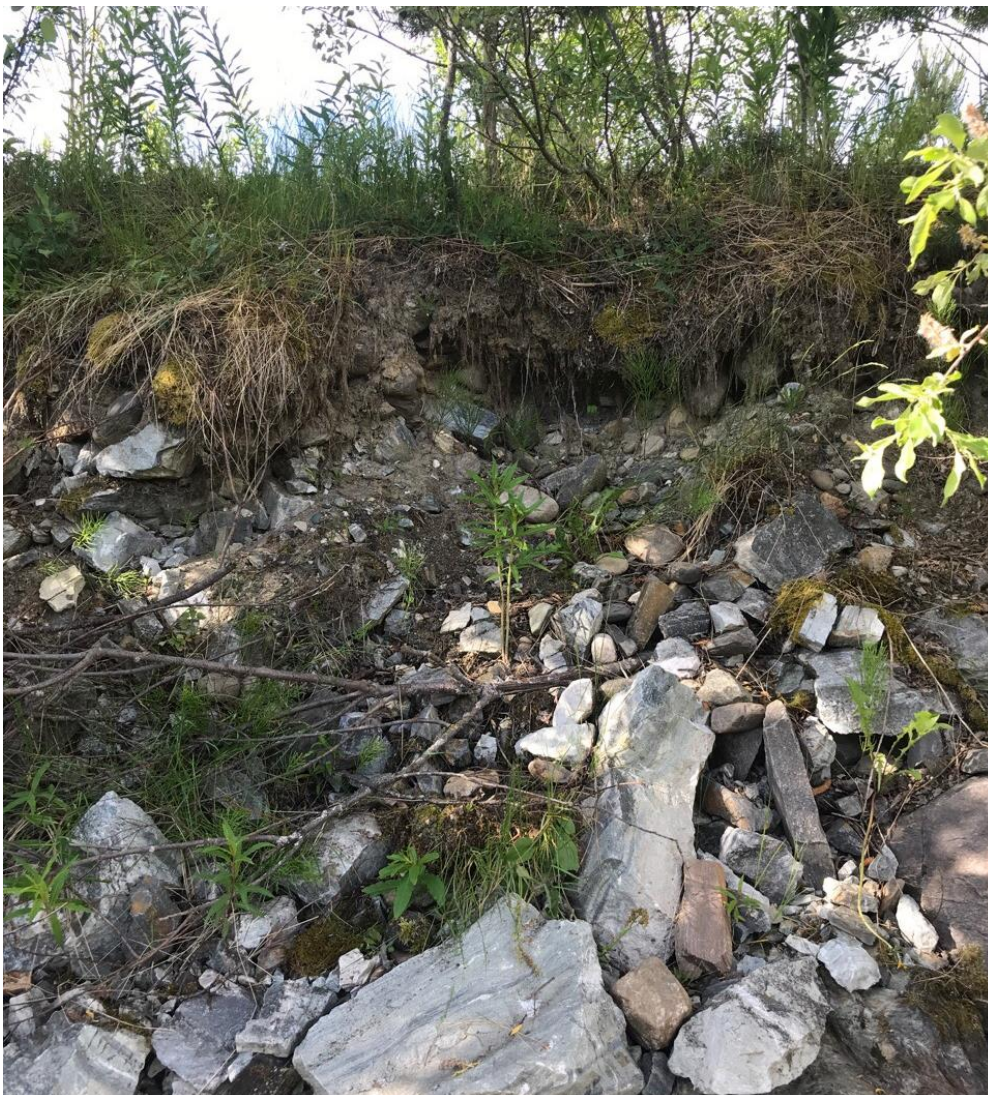
Figur 10: Skadet erosjonssikring ved parsell 1, pel nr. 1-50, se vedlegg 2 (Bilde: Multiconsult).
