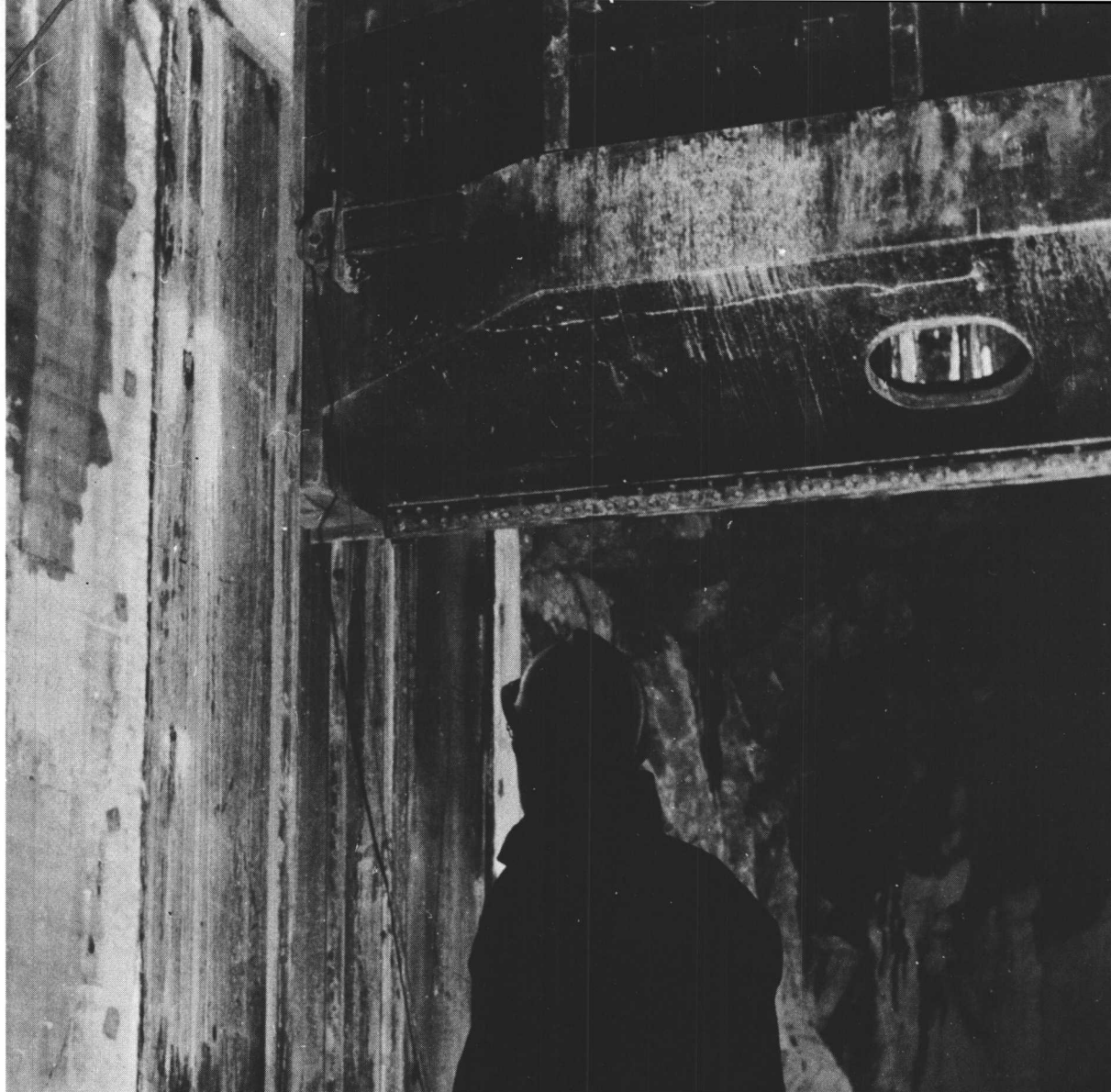
En av de to lukene i omløpstunnelen ved Solbergfoss.
