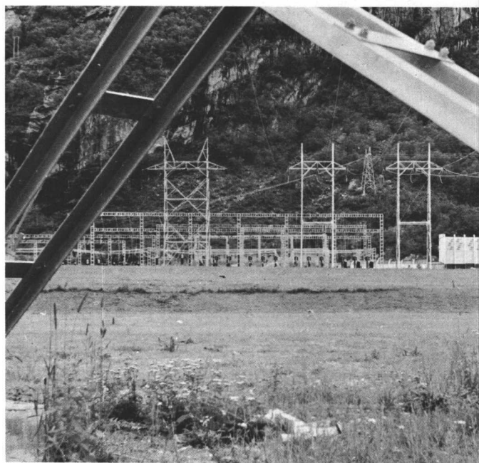
Utendørsanlegget Aura kraftverk, Sunndalsøra.
